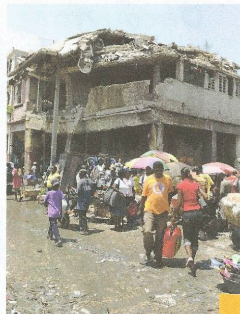
La plupart des bâtiments du centre-ville de Port-au-Prince restent encore affaiblis et risqués.
